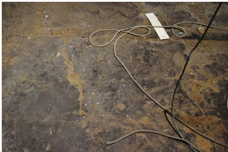
Figura 30: L'estradosso del solaio con una lesione in vista, ortogonale alla giacitura della trave (sopralluogo del 29 febbraio 2024).
