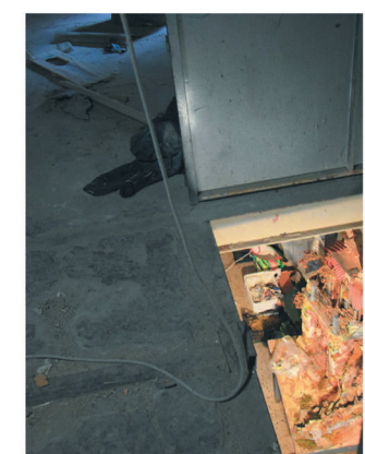
L'estradosso del solaio abusivo. (sopralluogo del 12 febbraio 2024)
