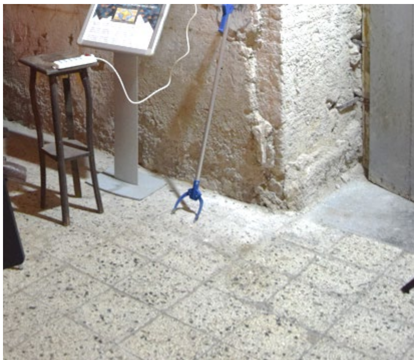
Figura 26: La pavimentazione in prossimità della controfacciata (sopralluogo del 29 febbraio 2024).
