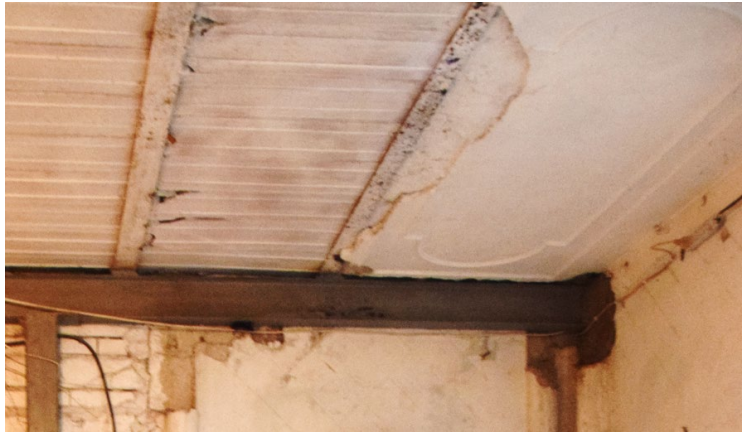
Figura 27: L'interfaccia tra solaio originario e solaio abusivo (sopralluogo del 29 febbraio 2024).
