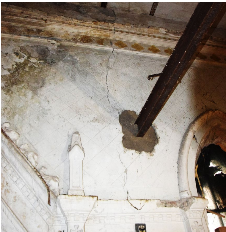
Figura 37: La lesione causata dalla trave d'argano sul fronte in affaccio su via d'Alagno (sopralluogo del 12 febbraio 2024).
