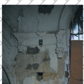
Foto 14 (12.02.2024) Degrado al di sotto della trave d'argano
