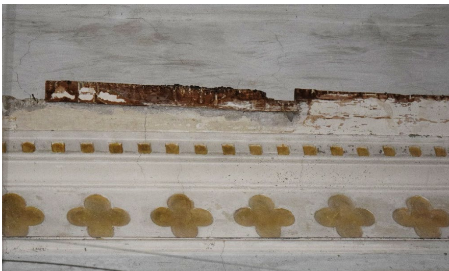
Figura 34: Tracce di intelaiatura lignea sulla cornice, a circa 50 cm dall'intradosso della copertura (sopralluogo del 12 febbraio 2024).
