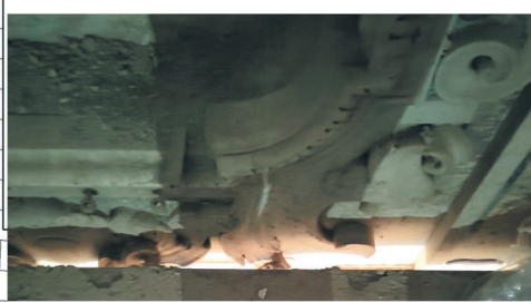
Foto 8 (12.02.2024) Particolare del bordo del solaio in prossimità dell'altare principale
