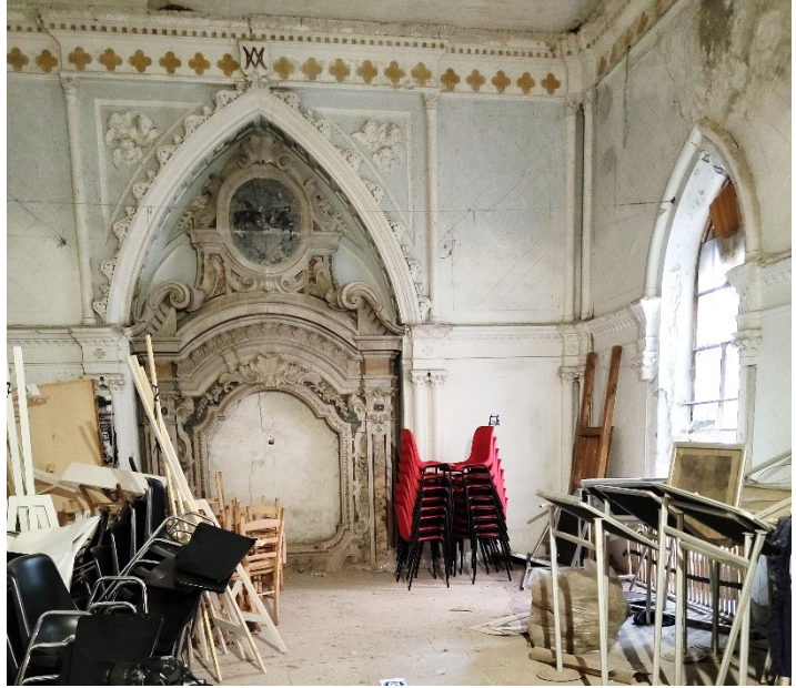
Figura 18: Il solaio abusivo all'estradosso (in basso) e l'altare fanzaghiano. Si osservi in particolare la miglior conservazione degli intonaci nell'ambiente, riscontrabile ad esempio nella tinteggiatura azzurra delle pareti (sopralluogo del 12 febbraio 2024).
