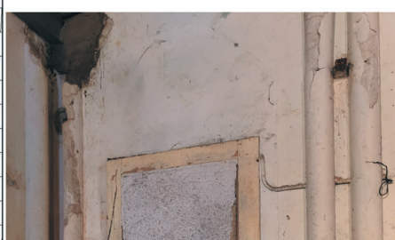
Foto 6 (12.02.2024) Dettaglio dell'accesso murato alla sagrestia e ancoraggio di una trave principale del solaio
