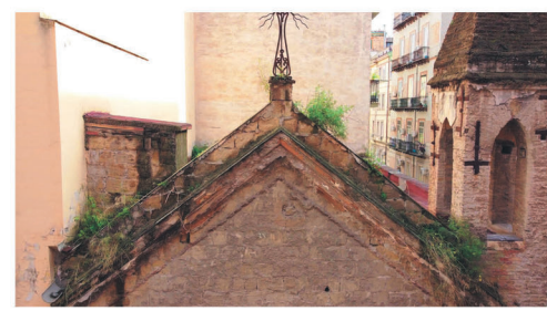
Foto 2 (29.02.2024) Crescita di vegetazione e degrado sul timpano
