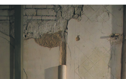
Foto 17 (29.02.2024) Degrado di una faccia interna della chiesa e parziale tamponatura di una bifora
