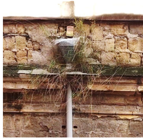
Figura 24: L'attacco della pluviale (sopralluogo del 29 febbraio 2024).
