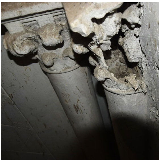
Figura 43: Uno dei capitelli delle lesene. All'interno, è possibile osservare il nucleo in calcestruzzo/malta a base cementizia delle lesene (sopralluogo del 12 febbraio 2024).
