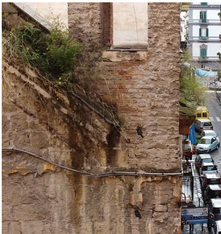
Figura 23: Elementi di vario tipo fissati alla facciata principale in prossimità della torre campanaria (sopralluogo del 29 febbraio 2024).
