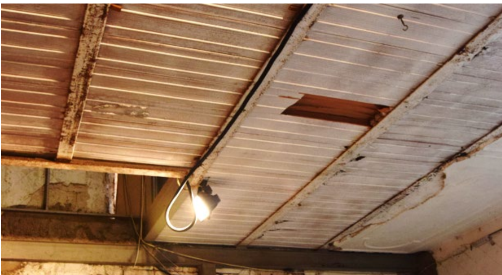
Figura 28: Il cavedio e il tavellone soggetto a sfondellamento (sopralluogo del 29 febbraio 2024).
